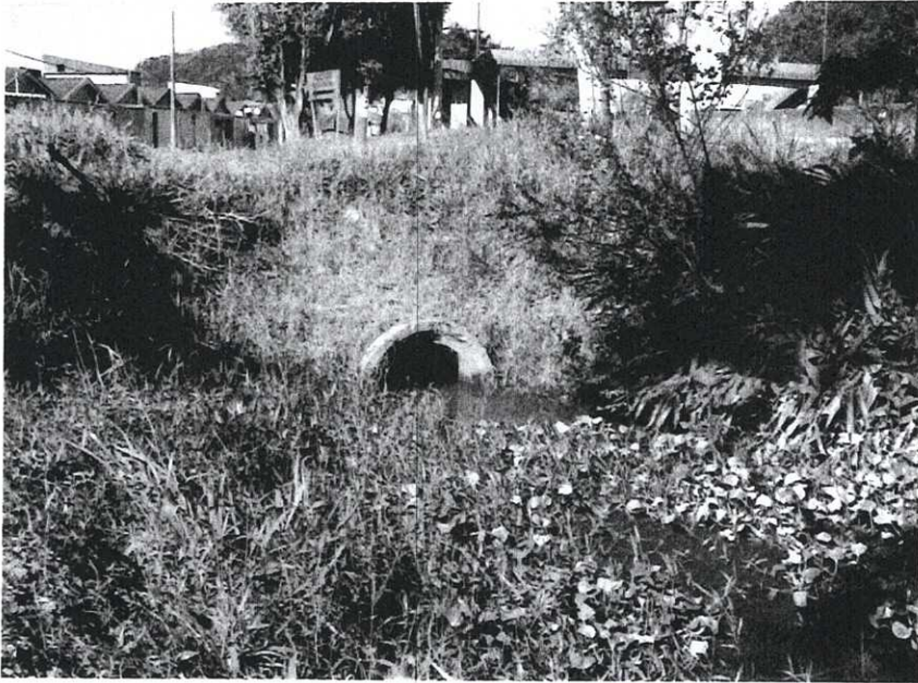
Figura 10: Tubo de 800 mm de diâmetro em direção ao Costa Muniz sob acesso a Rod. Padre Manoel da Nóbrega. Esse tubo interliga a vala da Vila Noel ao poço de visita da linha férrea próximo a Vila Natal.
