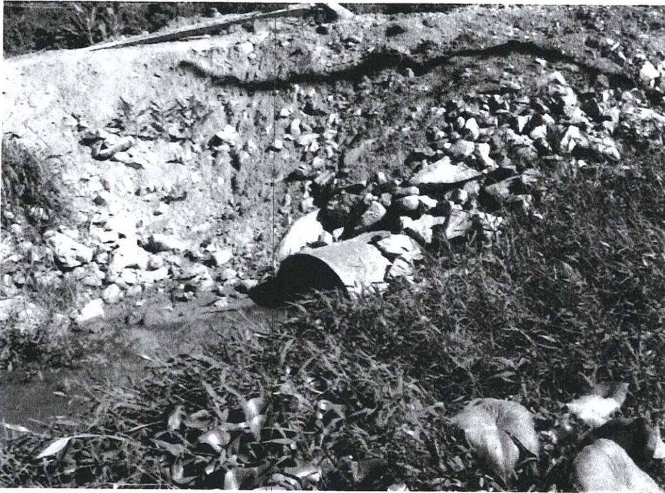
Foto 09: tubo de drenagem de 500 mm de diâmetro, a jusante da Vila Noel e a montante do Costa Muniz, instalada pela ECOVIAS.
