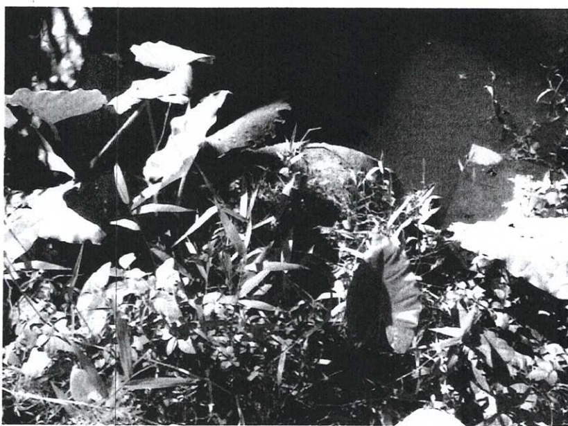
Foto 05: Saída do extravasor de drenagem do Poço de Visita da linha férrea, citado acima com 600 mm de diâmetro.
