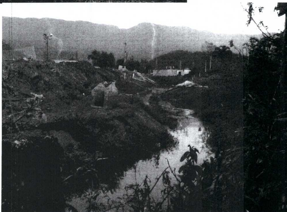
Foto 34: Crescente Movimentação de terra A margem do corpo d'água que drena uma área alagadiça (piscinão) no ATERRO 01.
