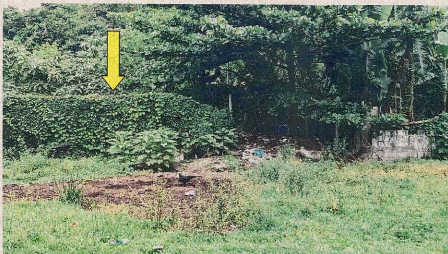
Foto 5: Defesa de concreto tomada por vegetação.
