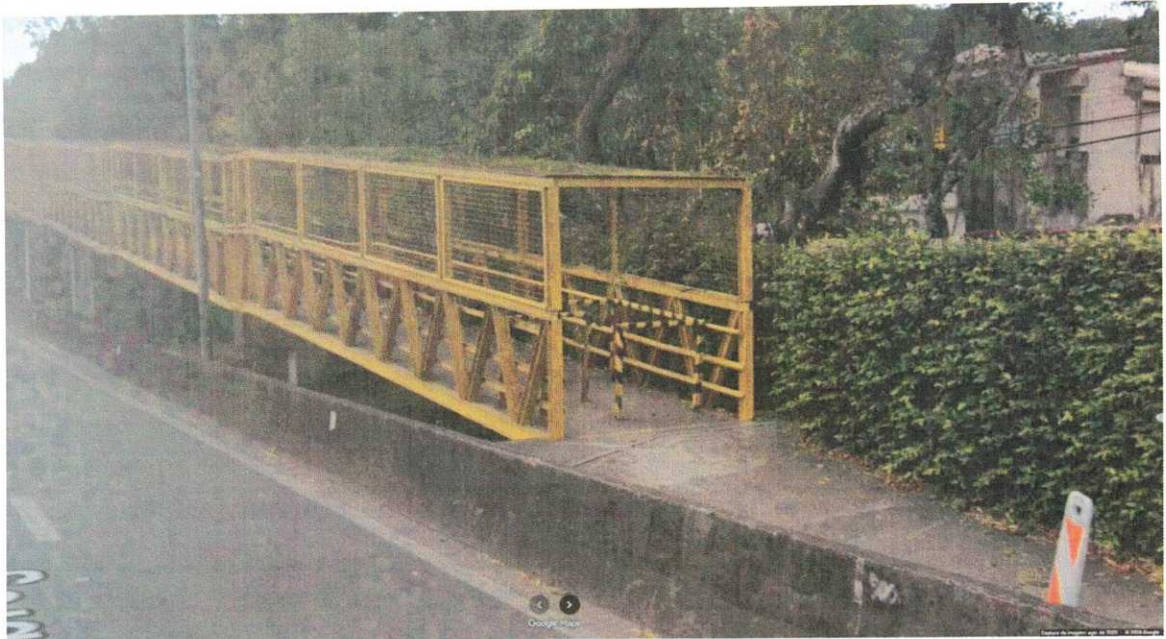
Passarela do Bairro Vale Verde com barreiras de acessibilidade – Imagem Extraída do Google Street View
