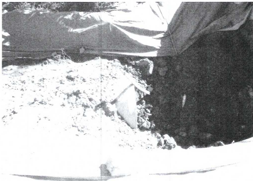
Foto 30: Passagem da drenagem da Rodovia Cônego Domênico Rangoni até o canal Av. Jornalista Giusfredo Santini.
