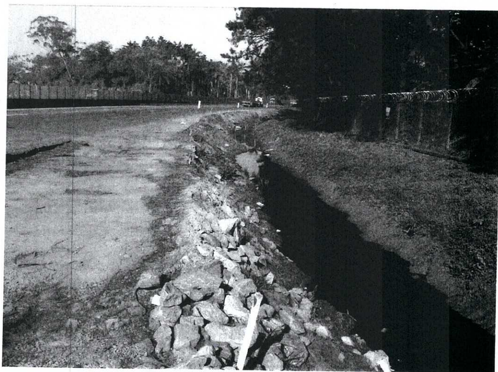
Foto 42: Idem acima. No caso dessas duas fotos, as águas pluviais estão sendo direcionadas para o canal da Av. Jornalista Giusfredo Santini.
