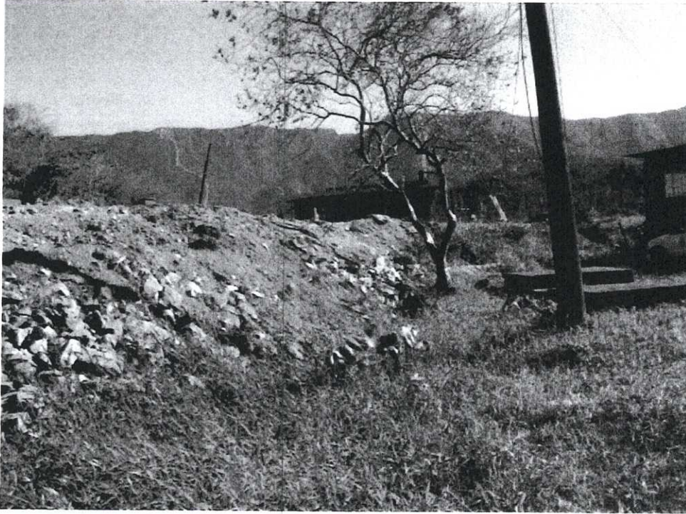
Foto 08: Vala a jusante da Vila Noel e a montante da Costa Muniz, parcialmente aterrada pela obra da ECOVIAS (ATERRO 01).
