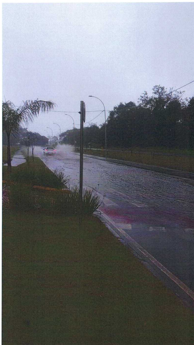
Imagem 08 – Sistema viário comprometido pelo acúmulo de água.
